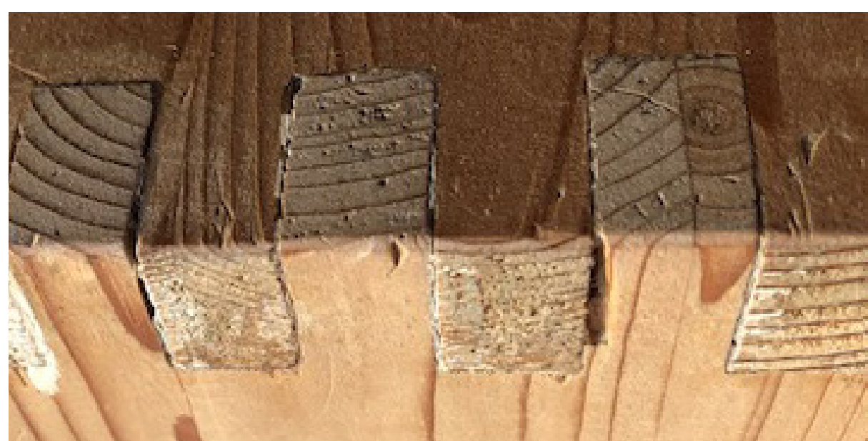
Appréciation de la provenance : fabriqué à l'atelier de bois de la HfG avant fin 1968.
